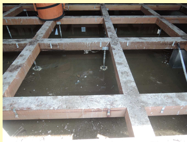
床下に入った汚泥 (乾燥しても悪臭の原因になります)
