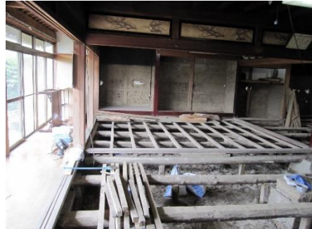
長沼地区の古民家被災状況
