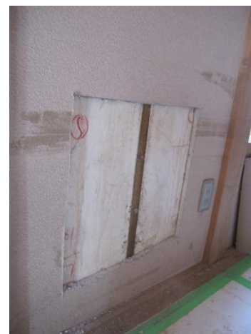
通気工法（在来木造）内部への浸水被害
