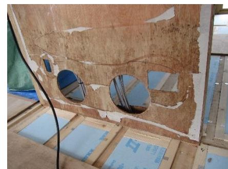
木質パネル構造の被害状況
