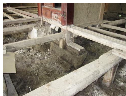
在来木造（昭和初期）の被害状況
