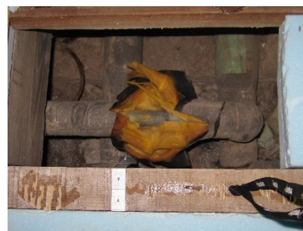
床下暖房用給湯管の保温材(グラスウール)の水分が抜けていない状態 R2.12月
