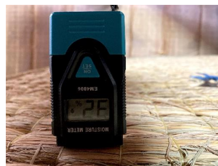
浸水後床下乾燥が不十分なため、床板が湿り、畳の含水率は32% R2.7月
